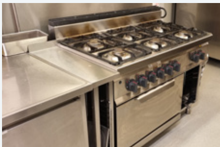
▲ Det nye gasskokebordet øker og forbedrer kapasiteten på matlagingen på Vesle Skaugum. Foto: Geir Arne Nordfjord
