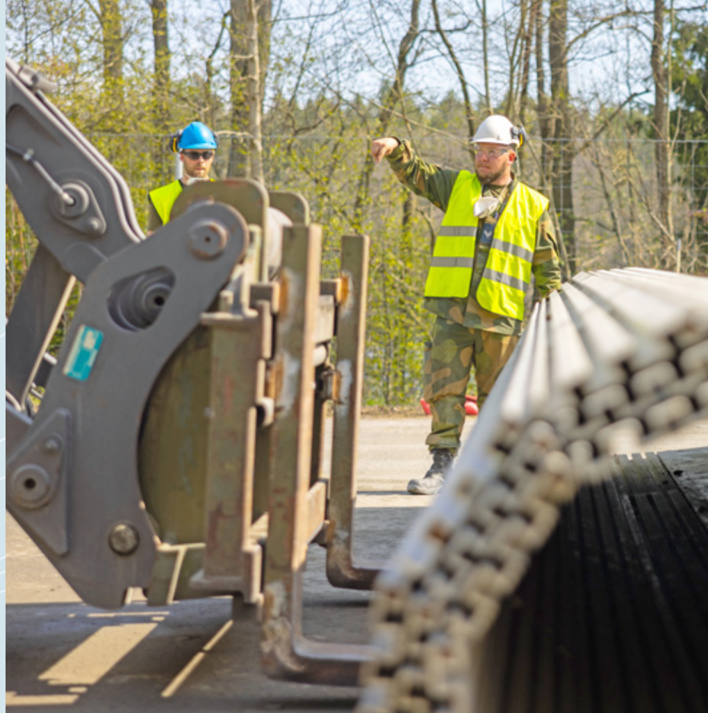
▲ Det skal lande og ta av med F-35 kampfly på rullebanen etter reparasjonen, og et fly som koster mange milliarder kroner, krever det nøysomhet i arbeidet. Foto: Fabian Helmersen
